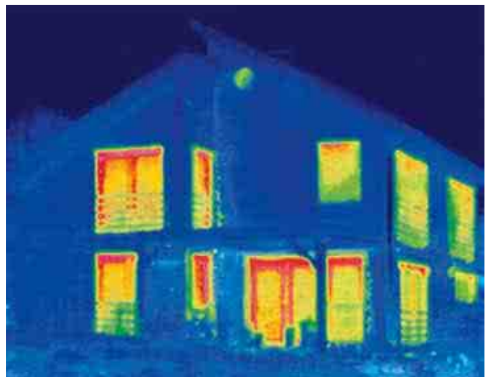
Thermografie vor dem Einbau neuer Schüco Thermo 6 Energiesparfenster
